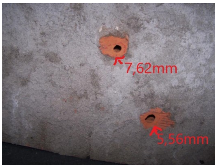
Figura 2 – Impactos de munições 5,56 mm e 7,62 mm, respectivamente, em uma parede de tijolo de aproximadamente 10 cm
