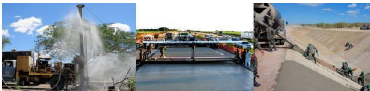
Fig 1- Obras de perfuração de poços, duplicação da BR- 101/ NE, Integração da Bacia do São Francisco (PISF) Fonte: Sistema Informatizado de Obras de Cooperação – 2019.
