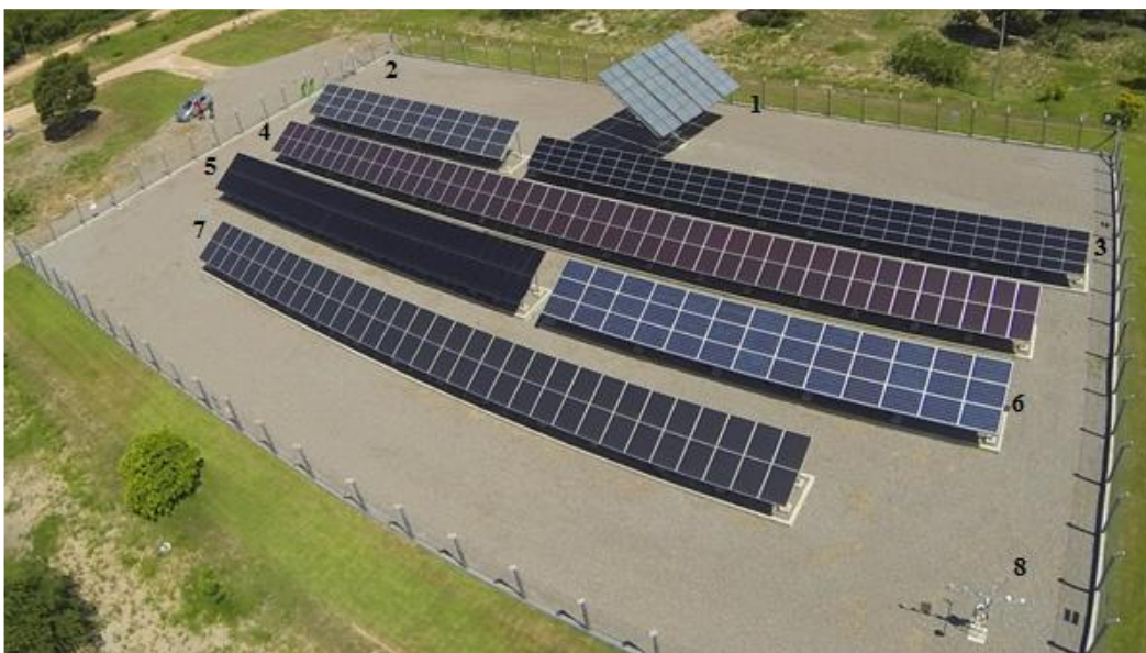
Figura 14 - Imagem aérea do módulo de avaliação de Capivari de Baixo - SC, com indicação da localização de cada sistema FV (1. CPV, 2. c-Si, 3. CdTe, 4. a-Si, 5. CIGS, 6. p-Si, 7. a-Si/ \mu c-Si) e da localização da estação solarimétrica (8).
