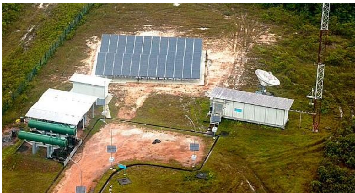
Figura 9 - Sistema fotovoltaico autônomo da Força Aérea Brasileira no 4º Pelotão Especial de Fronteira de Surucucu – RR Fonte: Fernandes, 2013
