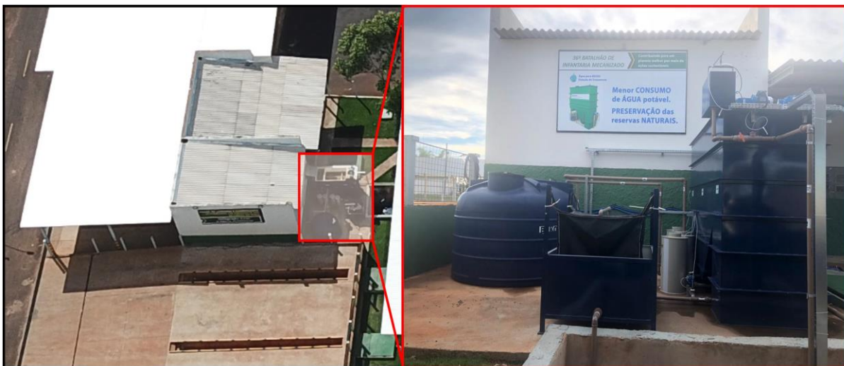
Figura 13 - Estação de tratamento de água
