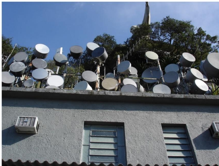
Figura 04 - Site da Rede Metropolitana - Estação Corcovado Fonte: 2º CTA
