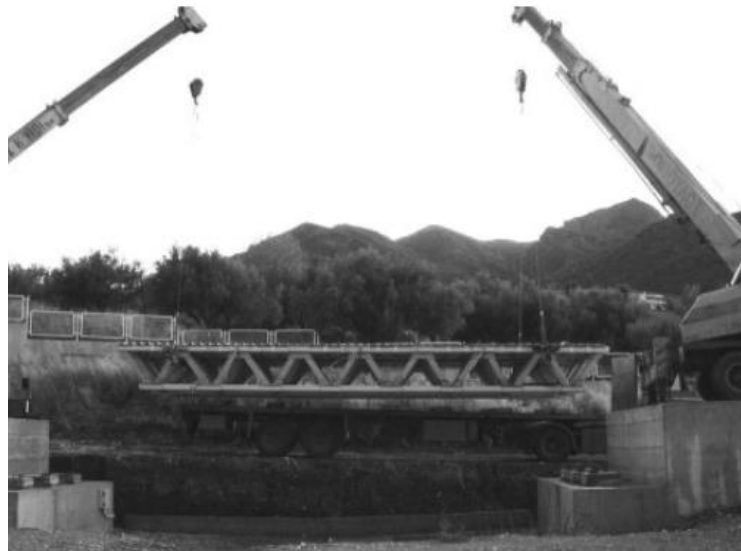
FIGURA 16 – Instalação da ponte sobre o vão com o auxílio de guindastes Fonte: KOSTOPOUOS et al., 2005
