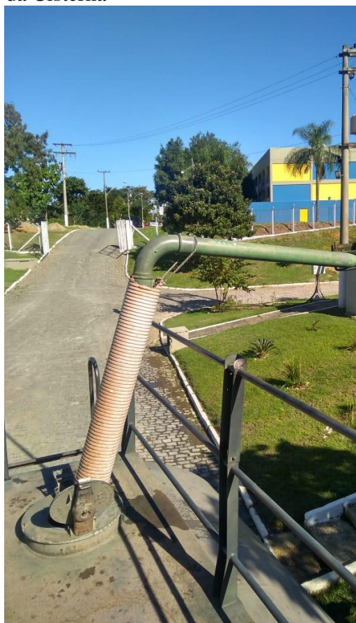
Figura 12 - Abastecimento da Cisterna
