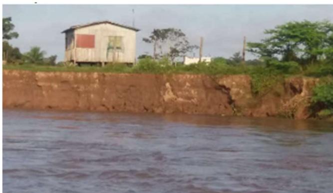
Figura 2 - Edificação em madeiro tipo palafita em período vazante apresentando o problema de terras caídas.
