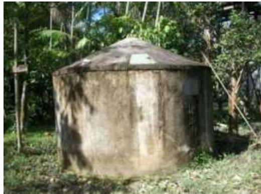
Figura 9 - Cisterna na Ilha grande.
