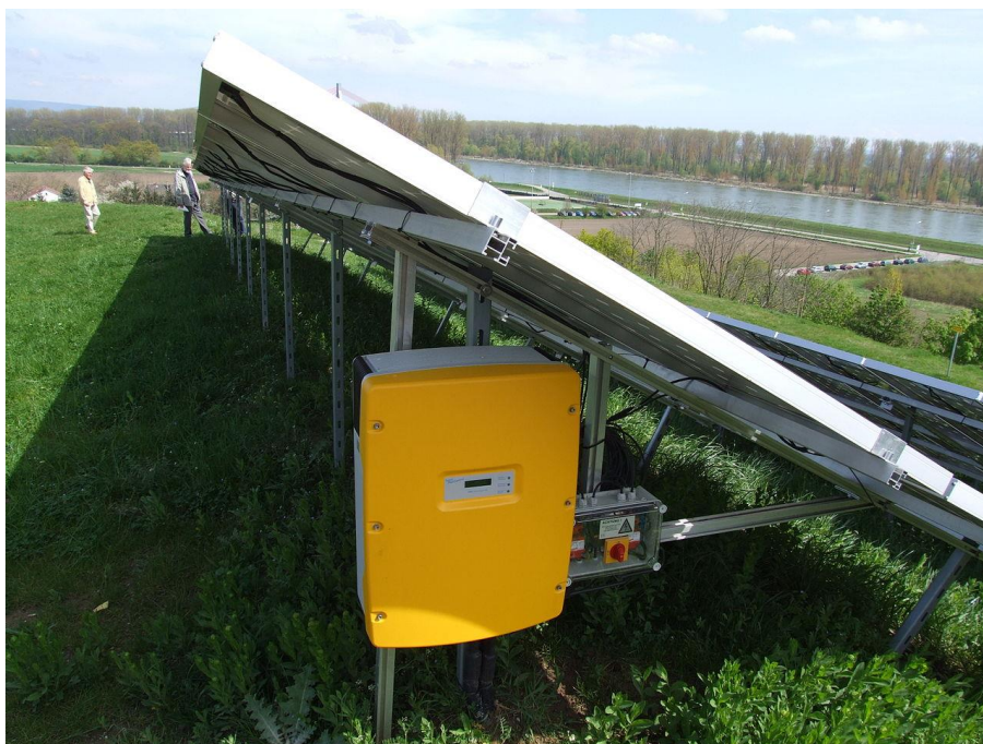
FIG 2.7 – Inversor de potência ligado a painéis solares (Mullberg Speyer, 2008)
