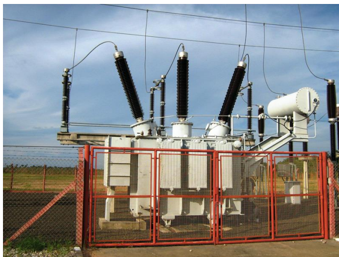
FIG 2.6 – Pára-raios em uma Subestação. (LABORSOLUTIONS, 2013)
