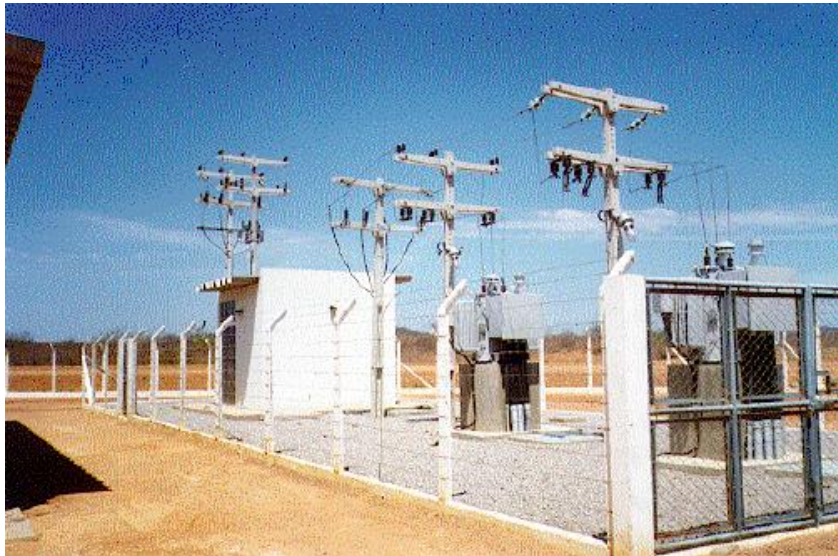
FIG 2.1 – Exemplo de Subestação ao Tempo. (DUAILIBE, 1999)
