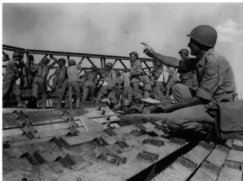
Figura 7 - Soldados sob comando do Capitão Floriano Moller, construindo uma ponte Bailey de 125 metros próximo a Pisa em setembro de 1994.
