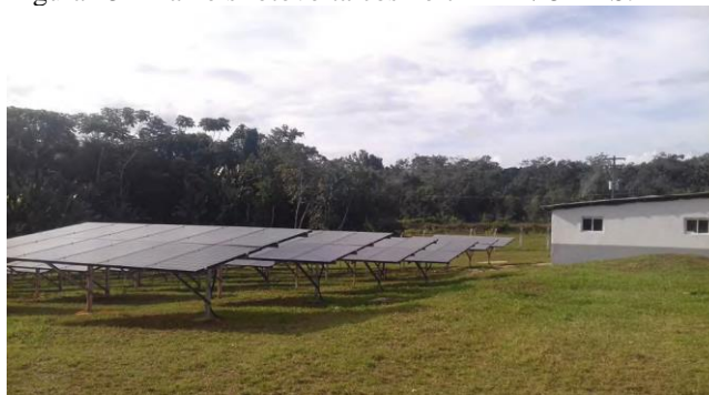
Figura 15 – Painéis fotovoltaicos no 7º PEF / 5º BIS.
