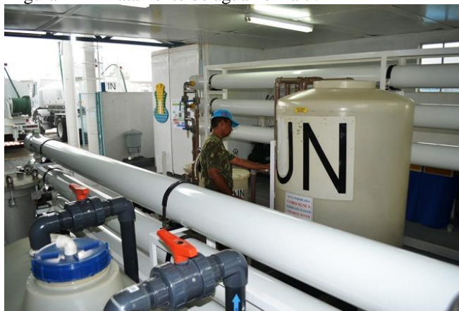
Figura 11 – Tratamento de água no Haiti.
