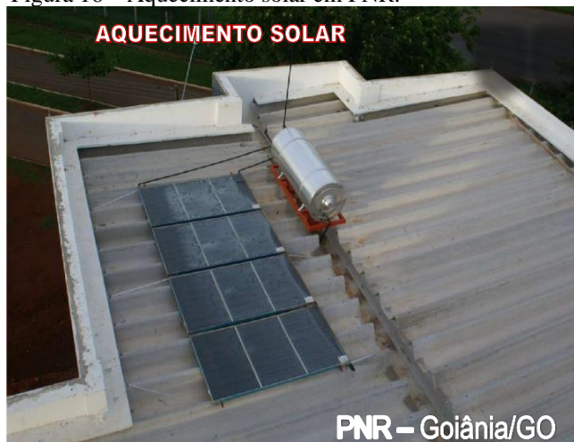
Figura 16 – Aquecimento solar em PNR.
