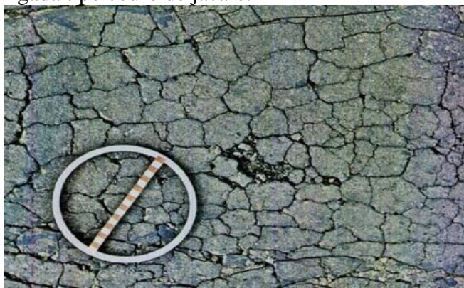
Figura 5: Trinca Interligada tipo couro de jacaré.
