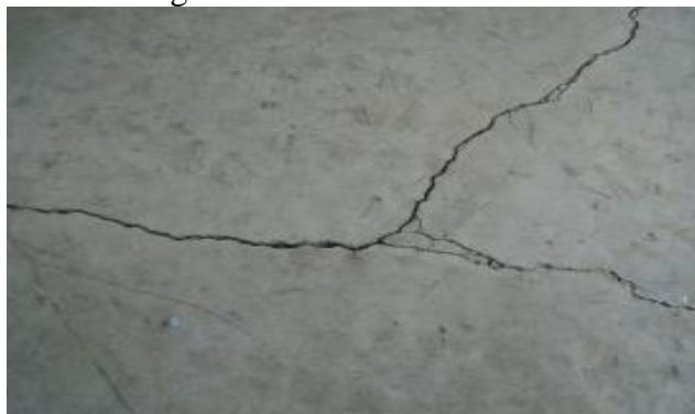
Figura 4: Fissura em pavimento rígido.
