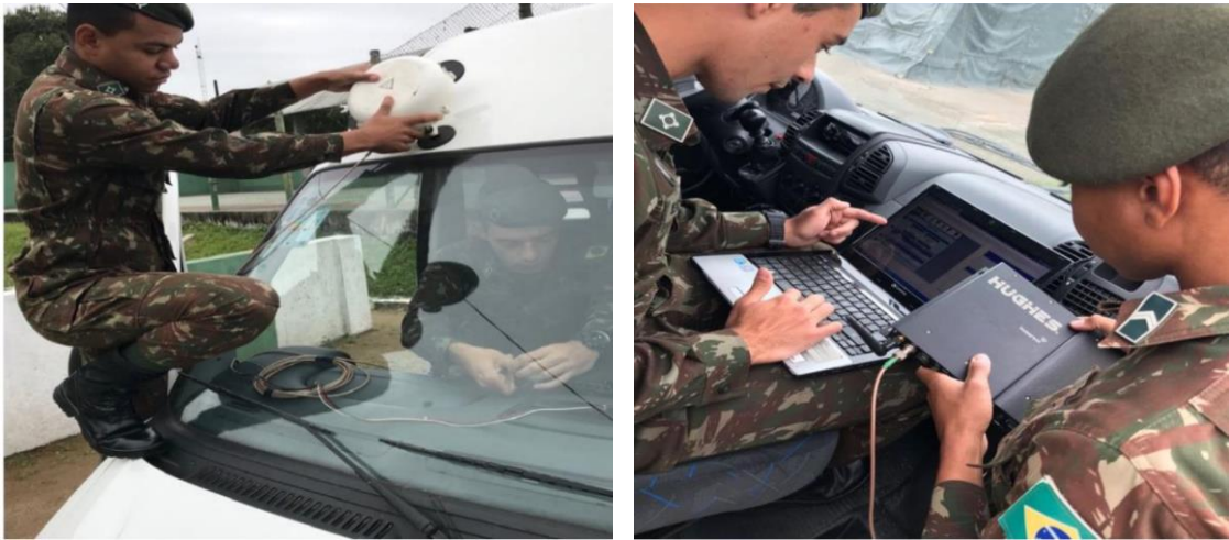
Figura 19: Instalação do BGAN (Inmarsat) em viatura
