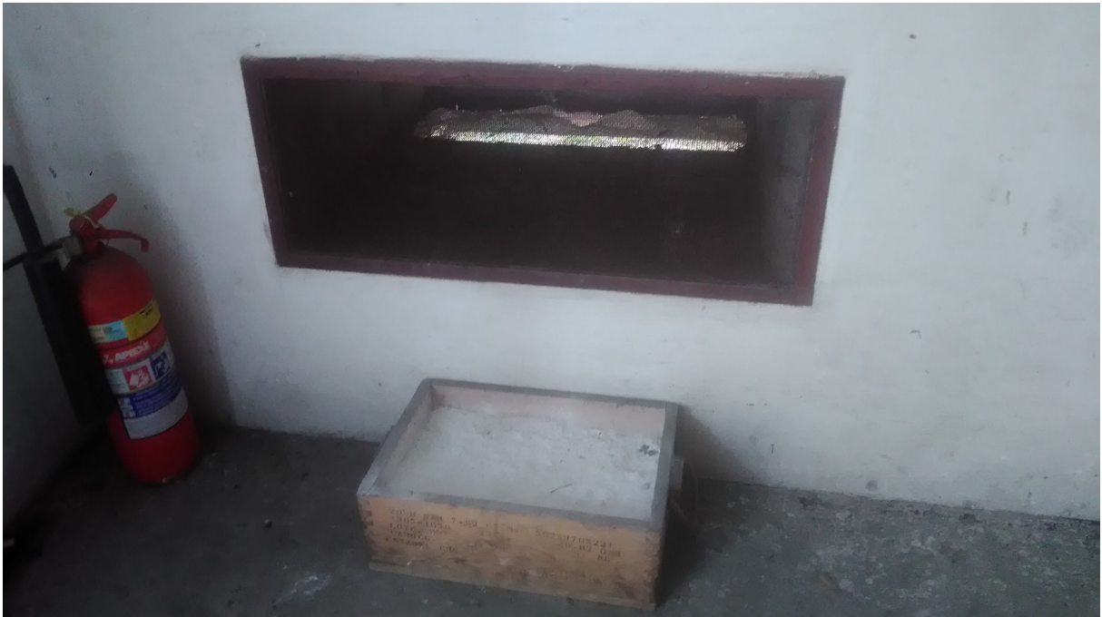
Figura 7 – Sistema de ventilação, Cal virgem e extintor de incêndio no interior do paiol
