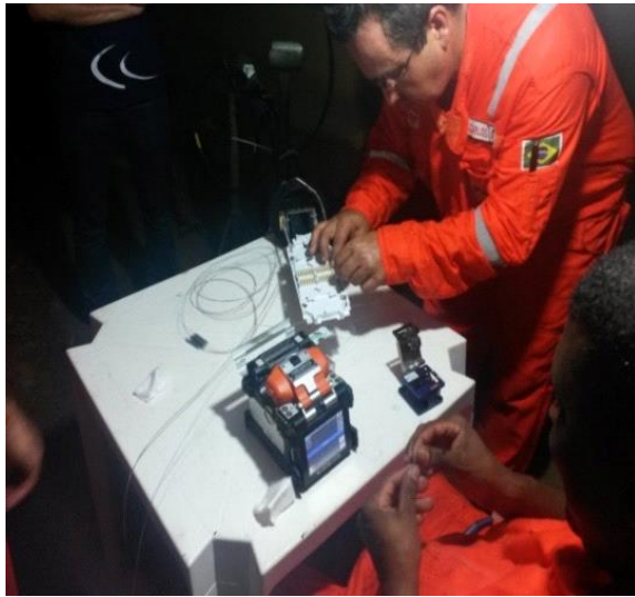
Figura 7 – Interconexão dos Cabos Ópticos Fluvial e Terrestre
