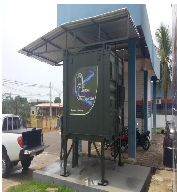
Figura 26 – CMAD Instalado em um Batalhão da PMAM
