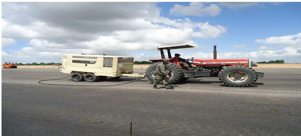
Figura 6: Compressor de ar
