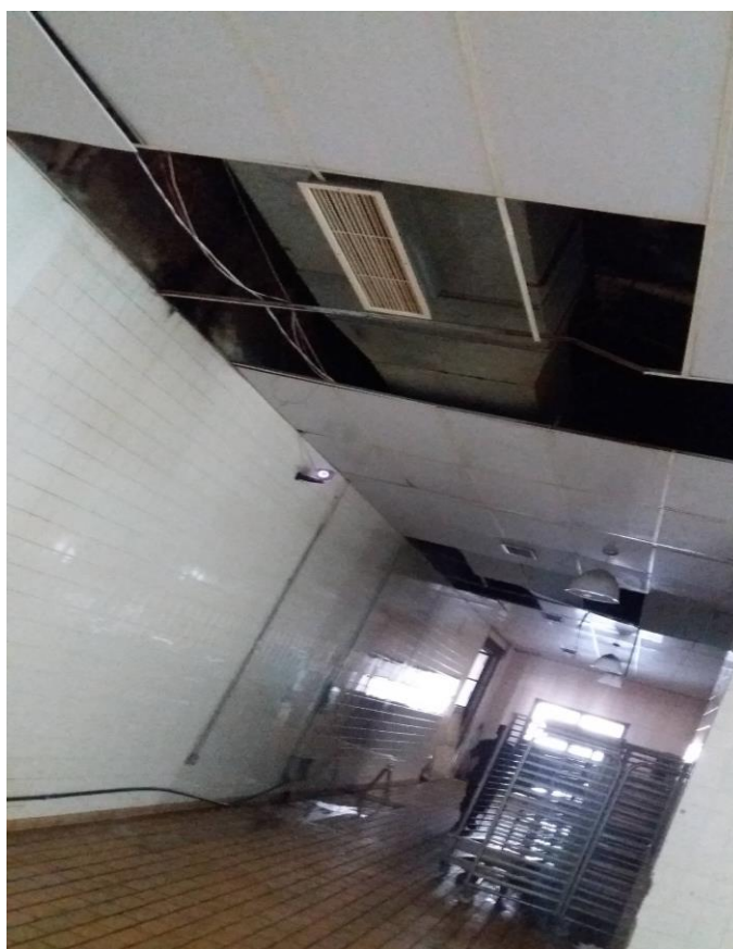
Figura 5 – TETO COM FORRO QUEBRADO (INTERIOR DO RANCHO)
