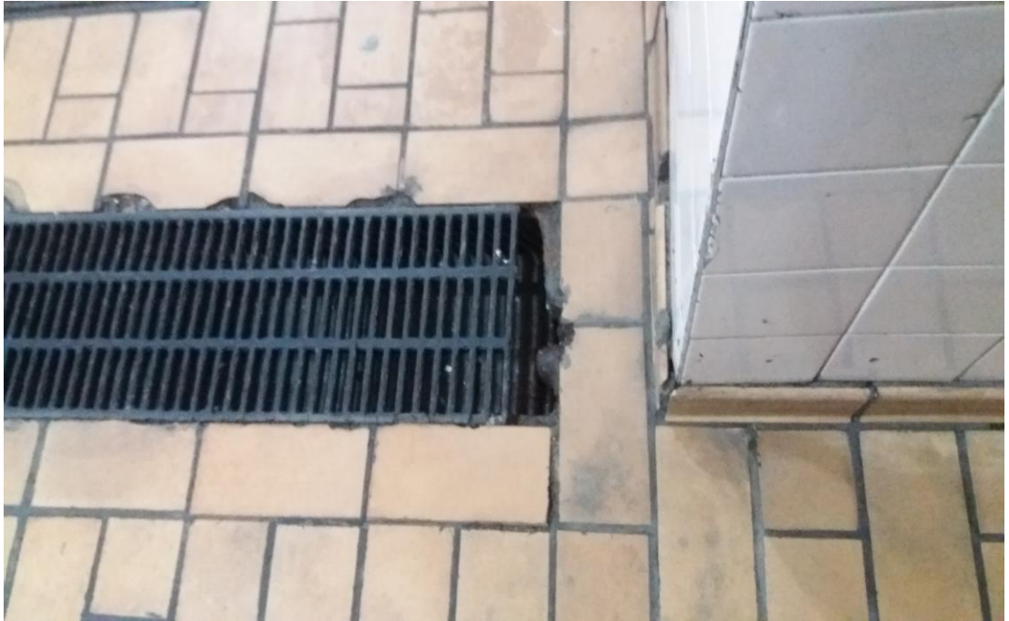
Figura 7 – RALO COM PROTEÇÃO METÁLICA ABERTO
