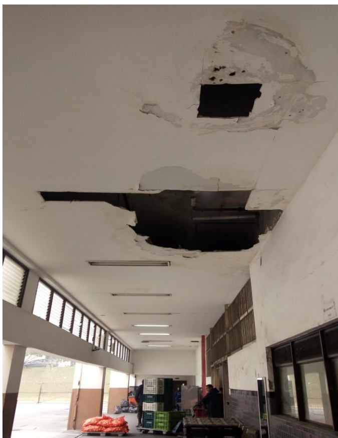
Figura 6 – TETO DE GESSO QUEBRADO (EXTERIOR DA COZINHA)
