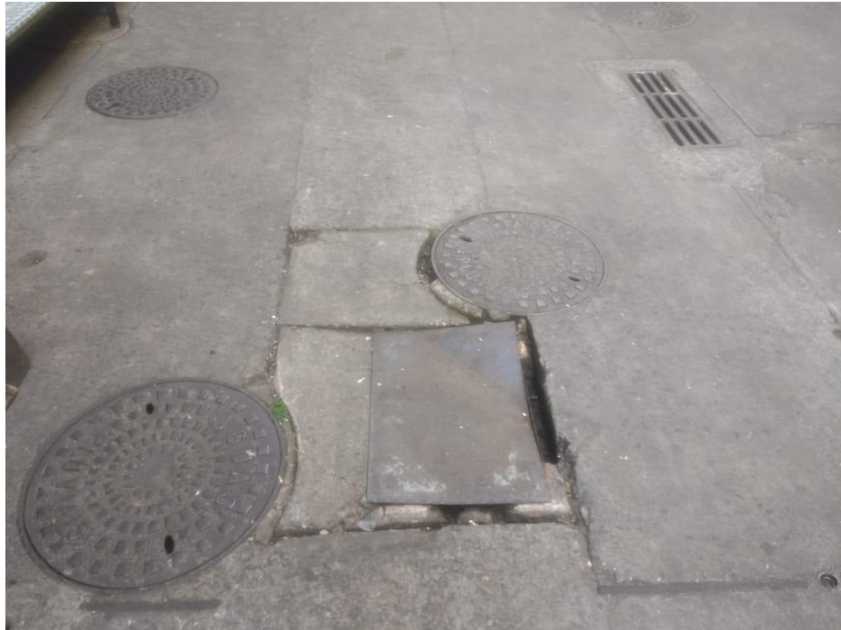
Imagem 5 – Buraco na entrada do Setor de Aprovisionamento
