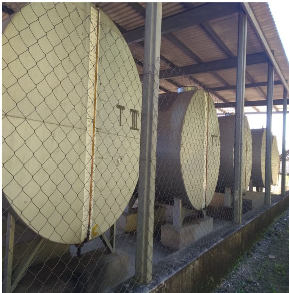
Figura 4: Tanque aéreo para armazenamento da AMAN
