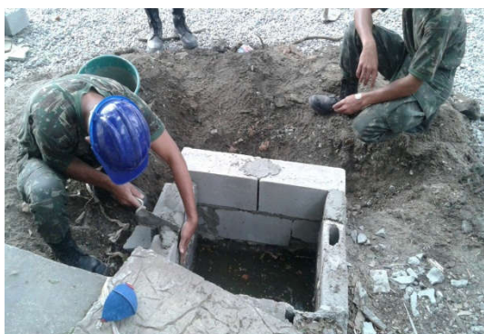
Imagem 30: Caixa de passagem Fonte: 12ª Cia E Cmb L (2016b, p. 5)
