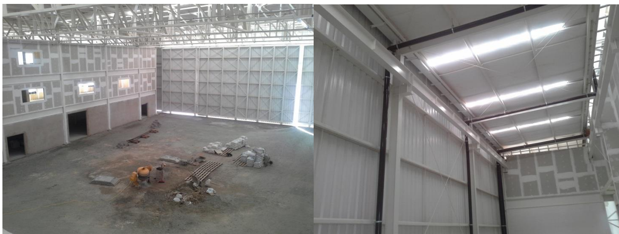
FOTOGRAFIA 1 – Oficina Sede (Central), Conforto espacial, térmico, acústico, luminoso e com instalações adequadas para o movimento de carga, teste e manutenção de implementos componentes dos diversos equipamentos e viatura
