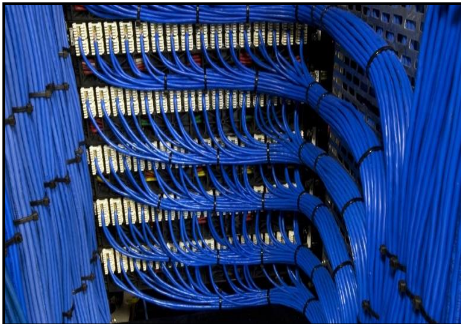
Fig 6-8 – Cabeamento estruturado para o estabelecimento enlace confinado para rede de computadores
