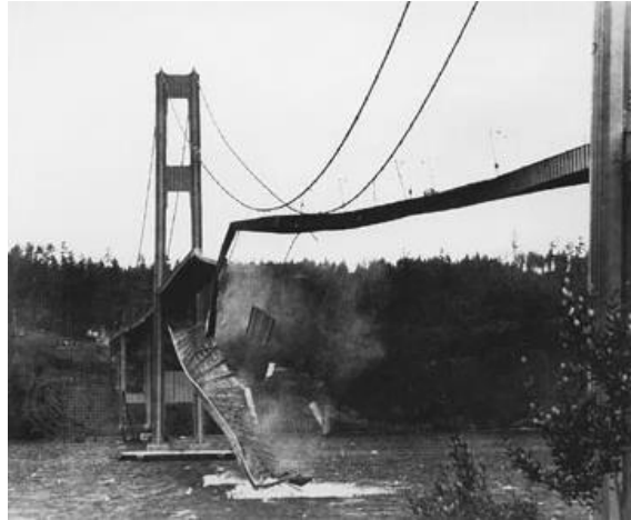
Fig. 3 – Ponte de Tacoma Narrows derrubada após vibração induzida pelo vento
