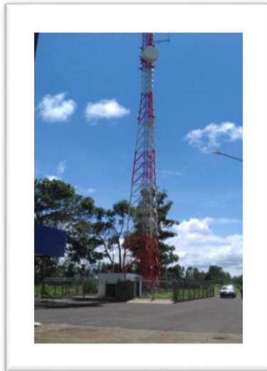
Figura 13- Antena da Infovia Fonte: BUDÓ, 2017, p.42
