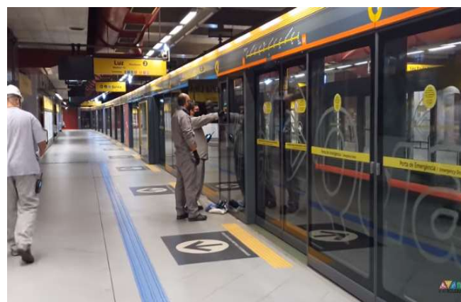
Figura 8 – Manutenção de equipamentos fixos Fonte: (LOBO, 2021)
