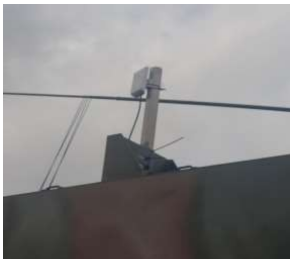
Figura 4.4.1 – Antena PTP instalada na viatura M577
