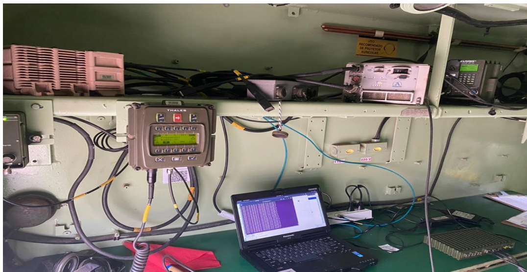
3- SOTAS M2 IP, SOTAS AUS, Inversor E CoTat Vtr M577
