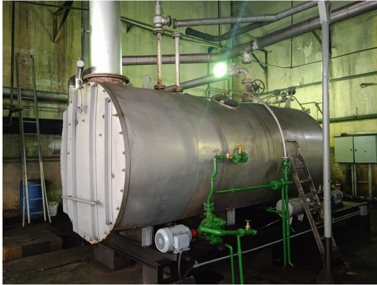
Figura 2 - Caldeira 1 do setor de abastecimento da AMAN
