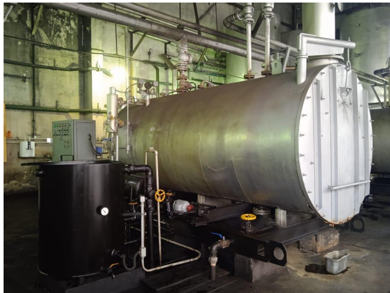
Figura 3 - Caldeira 2 do setor de abastecimento da AMAN
