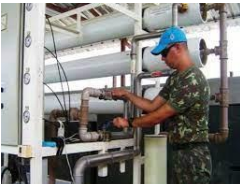
FIGURA 15- Purificação de água na Bra Eng Coy utilizando sistema de Osmose Reversa Fonte: Arquivo da BraEngCoy
