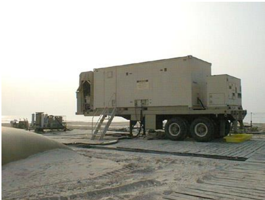
FIGURA 23- Equipamento móvel de osmose reversa
