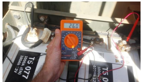
Fig 3. Multímetro digital sendo utilizado para a medição de tensão do conjunto de baterias da viatura.
