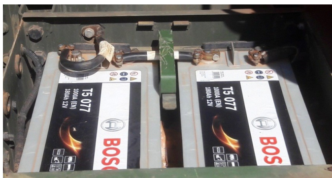
Fig 1. Conjunto de baterias do sistema elétrico veicular das Viaturas ASTROS
