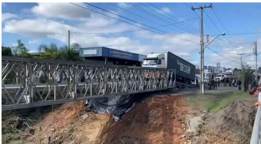
Figura 1 – Estrutura de concreto que existe no local precisou ser interditada e Exército foi mobilizado para medida provisória, uma ponte metálica
