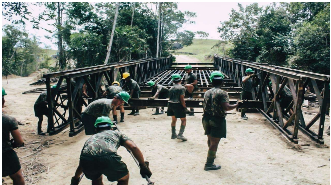
Figura 3 - EXÉRCITO BRASILEIRO MONTA PONTE BAILEY E REALIZA MELHORIA EM ESTRADA DA FAIXA DE FRONTEIRA COM A VENEZUELA
