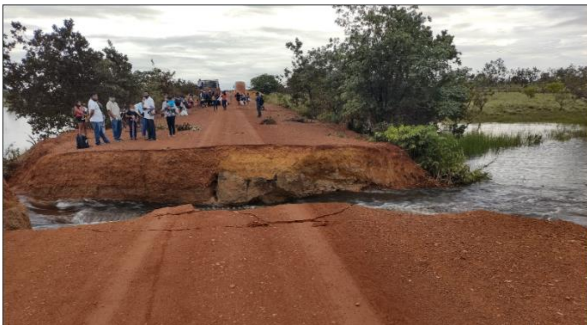
Imagem 1 - Bueiro rompido BR-401/RR, Terra Indígena Raposa Serra do Sol, município de Normandia-RR.
