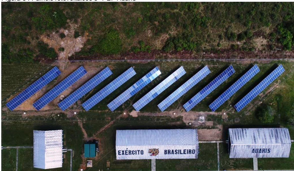
Figura 6 : Painéis fotovoltaicos 5º PEF Auaris
