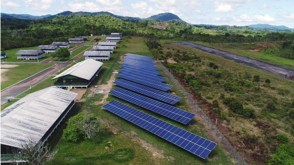
Figura 7: Painéis fotovoltaicos 5º PEF Auaris
