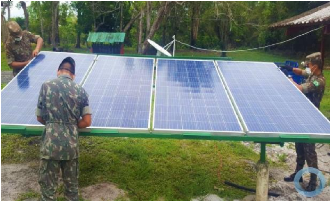
Figura 8: Painéis fotovoltaicos 5º PEF Maturacá
