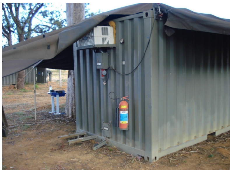
Fig. 5 – DMMC (Depósito Móvel de Munição Climatizado).
