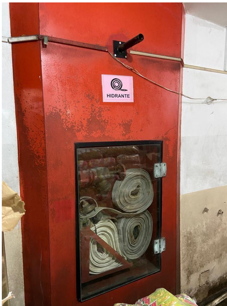
Foto 10 – Único hidrante presente no depósito.
