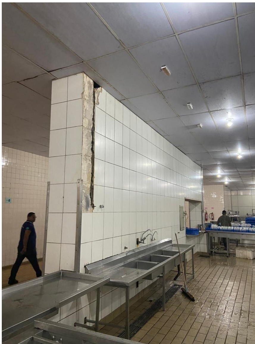
Foro 1 – Cozinha sendo lavada e azulejos quebrados
