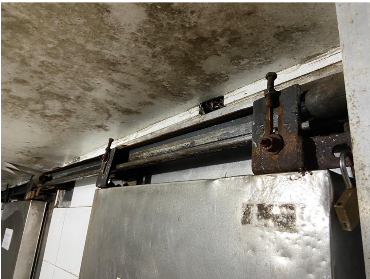
Foto 13 – Trilho da porta do freezer enferrujado
