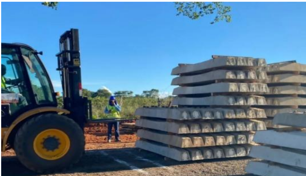
Figura 10 – Depósito de dormentes de concreto
