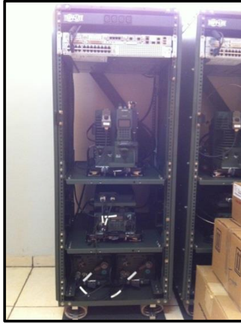
FIGURA 02 – Rack do MTO fora da viatura. Fonte: BRASIL (2012b).
