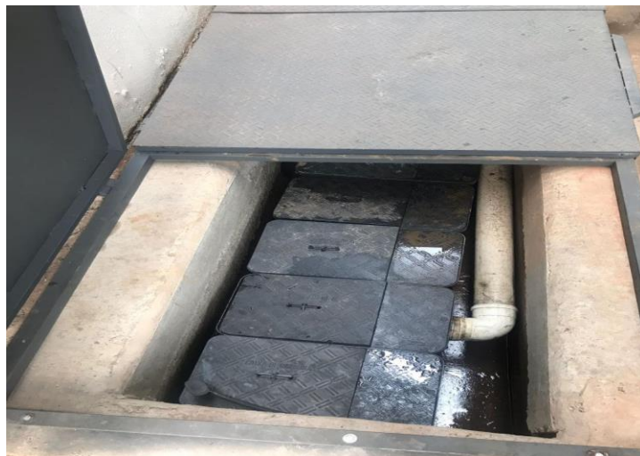
Figura 2: Caixa separadora de água e óleo.
