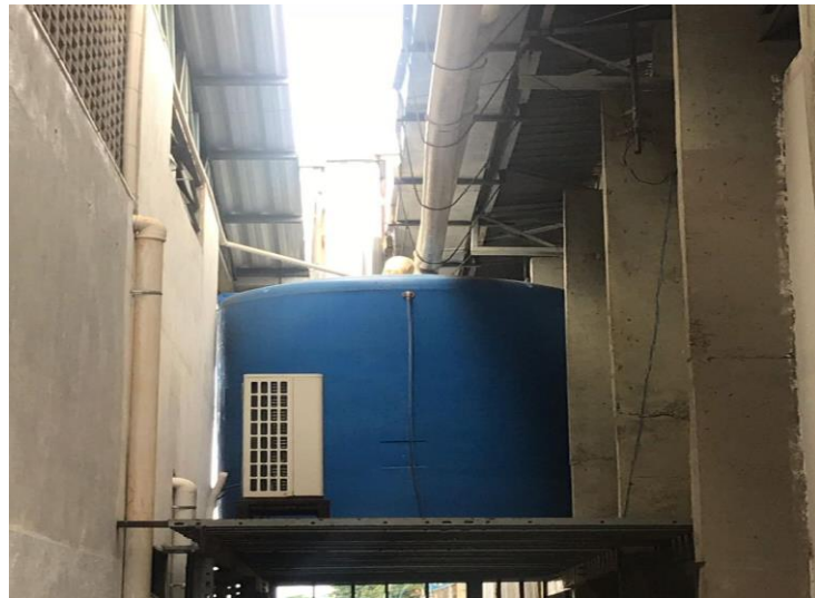
Figura 4: Tanque de água limpa e tratada mais a água da chuva
