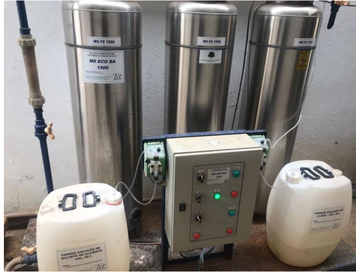
Figura 3: Equipamento que trata a água da caixa separadora.
