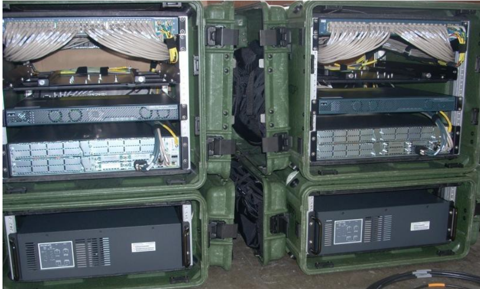
Figura 2- Nó de Posto de Comando do Batalhão Fonte: CONOPS for Warfighter Information Network-Tactical (WIN-T)
